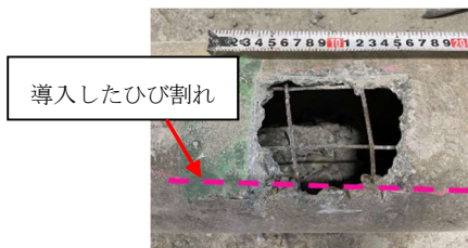
写真4 ヒューム管の内部鉄筋の腐食状(図7の□部分)
