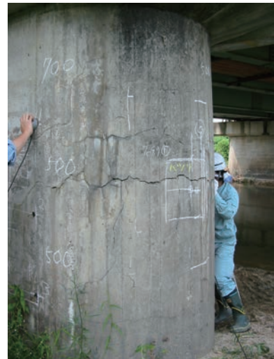
写真1 アルカリシリカ反応によってひび割れた橋
